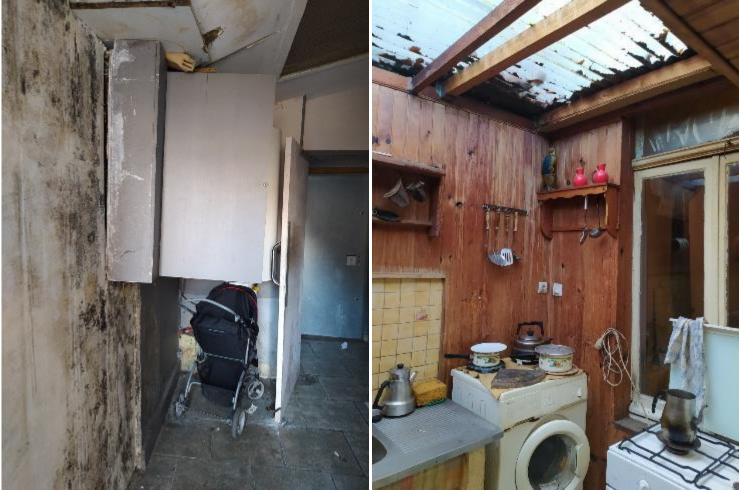
Figure 5 : Exemple d'immeuble dégradé sur le secteur
