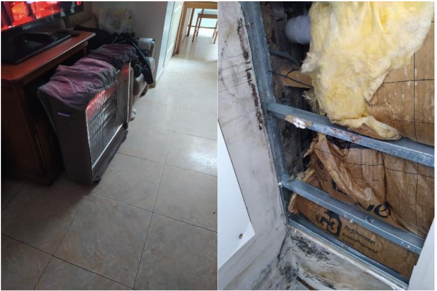
Figure 6 : Chauffage d'appoint et isolation dégradée dans des immeubles du secteur d'intervention
