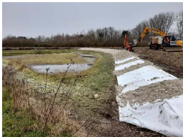
Des berges à stabiliser pour le bon fonctionnement des bassins filtrants de Leers, système de lagunage pour l'épuration des eaux alimentant le canal de Roubaix.
